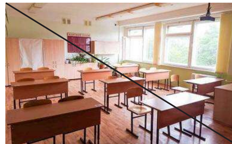
Плохо Линолеум под дерево
