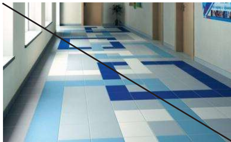
Плохо Цветные вставки из плитки
